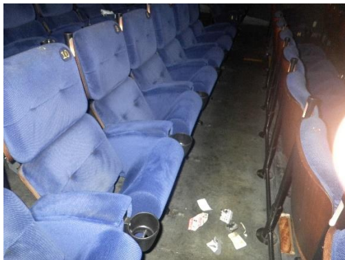
写真5 シアター内の焼損状況
